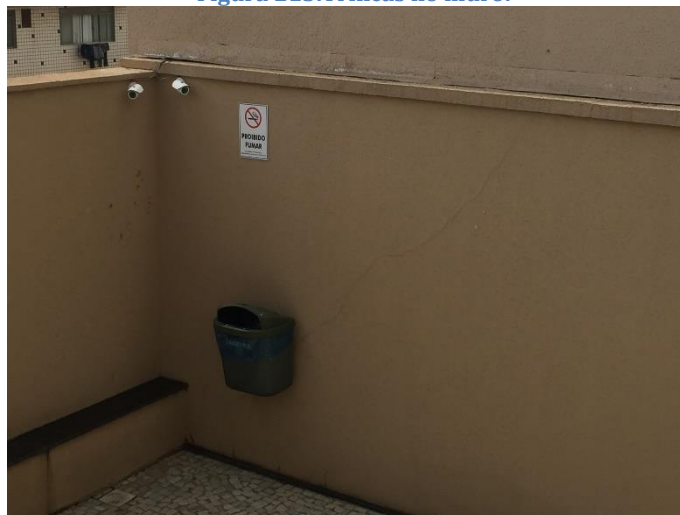
Figura 214. Trincas no muro.
