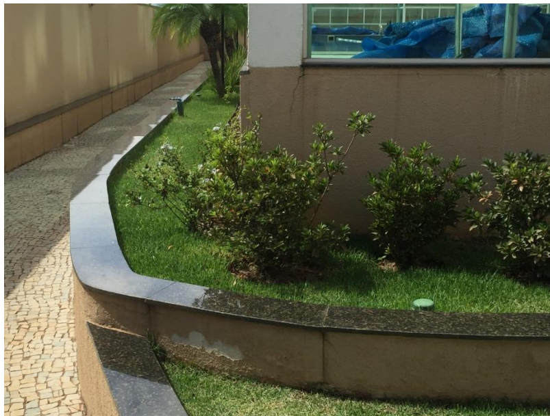
Figura 98. Ausência de rejunte no granito e de reparo na junta da base mureta de jardim.
