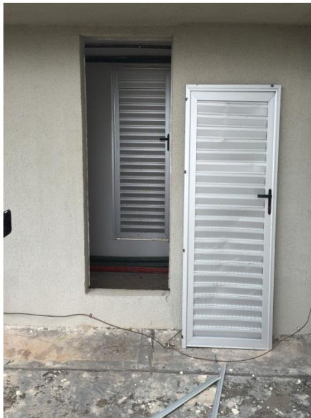
Figura 264. Sem porta de acesso à cobertura.
