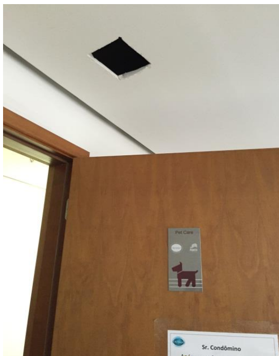
Figura 197. Buraco no forro.
