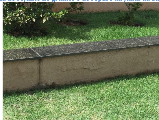
Figura 101. Ausência de rejunte no granito e de reparo na junta da base mureta de jardim.
