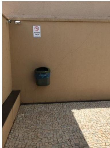
Figura 213. Trincas no muro.
