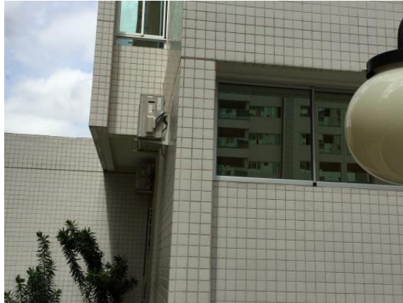
Figura 57. Aparelho de ar condicionado instalado posteriormente.
