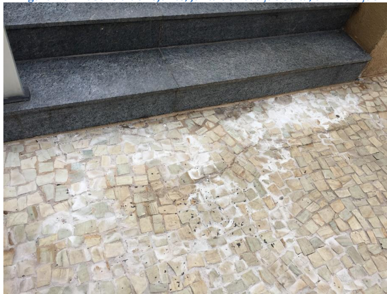
Figura 203. Ausência de rejunte, junta de vedação solta, e infiltração.
