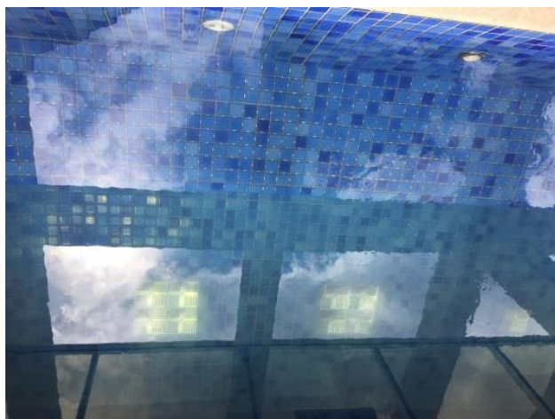
Figura 52. Ausência de rejunte.
