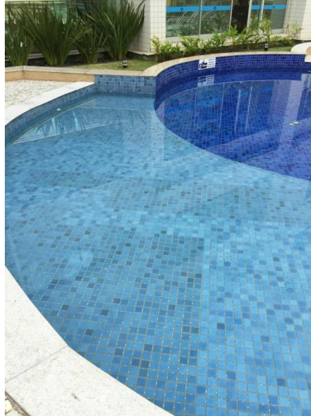
Figura 29. Deck molhado da piscina com ausência de rejunte entre as pastilhas.
