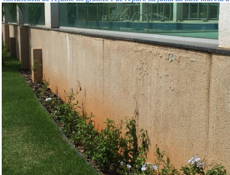
Figura 99. Ausência de rejunte no granito e de reparo na junta da base mureta de jardim.
