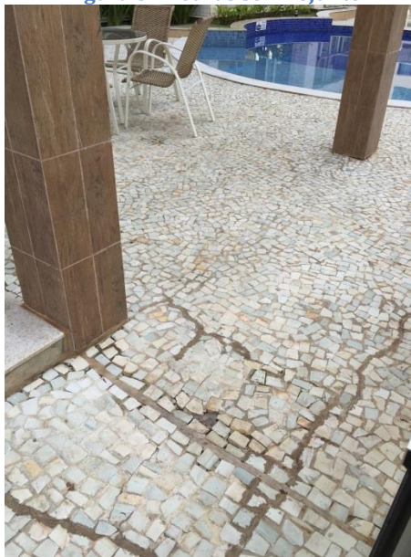
Figura 38. Trincas em pedra portuguesa.
