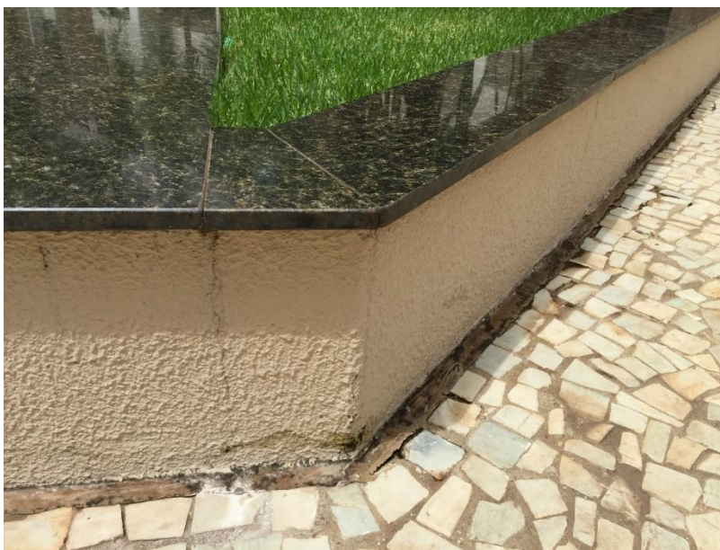
Figura 85. Ausência de rejunte no granito e trincas nas muretas de jardim.
