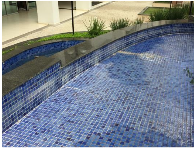
Figura 123. Pastilhas sem rejunte.
