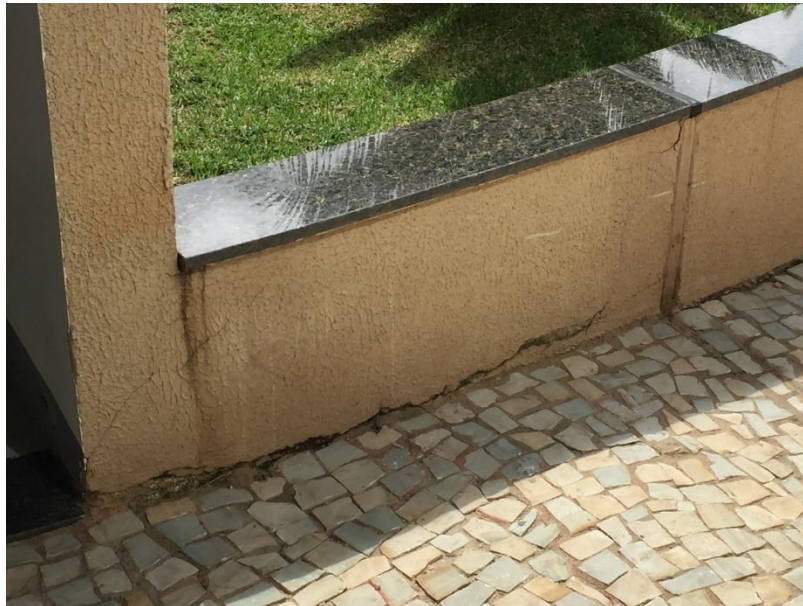
Figura 96. Ausência de rejunte no granito e de reparo na junta da base mureta de jardim.
