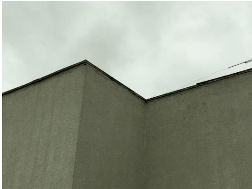
Figura 10.Trincas na parede da FACHADA.
