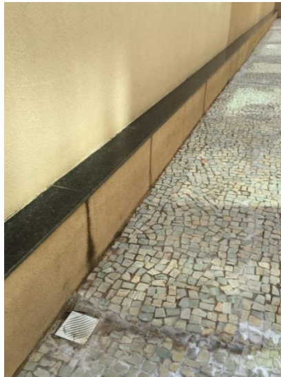
Figura 107. Ausência de rejunte no granito e de reparo na junta da base mureta de jardim.
