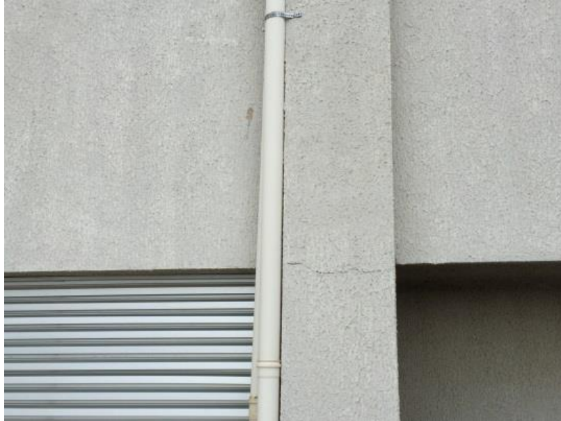
Figura 9..Trincas na parede da FACHADA.
