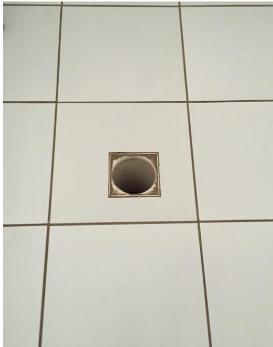
Figura 191. Ausência de acabamento do ralo.
