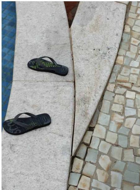
Figura 37. Pedras sem rejunte.
