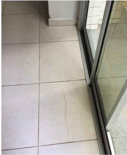
Figura 230. Ausência de rejunte.
