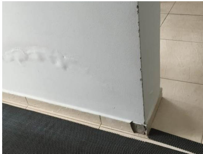
Figura 60. Pontos de infiltração em parede.
