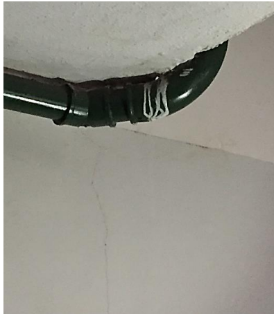
Figura 233. Infiltração dentro de escada de emergência.
