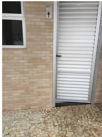
Figura 132. Pedra portuguesa danificada e sem rejunte.
