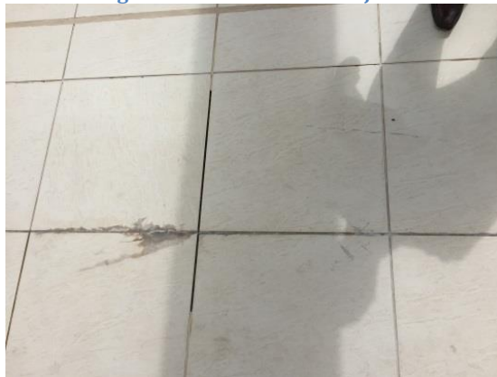
Figura 47. Cerâmica sem rejunte.
