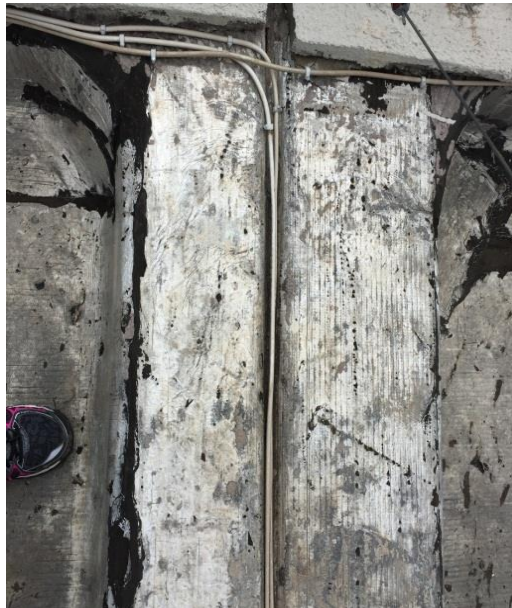
Figura 270. Danos na manta de impermeabilização.
