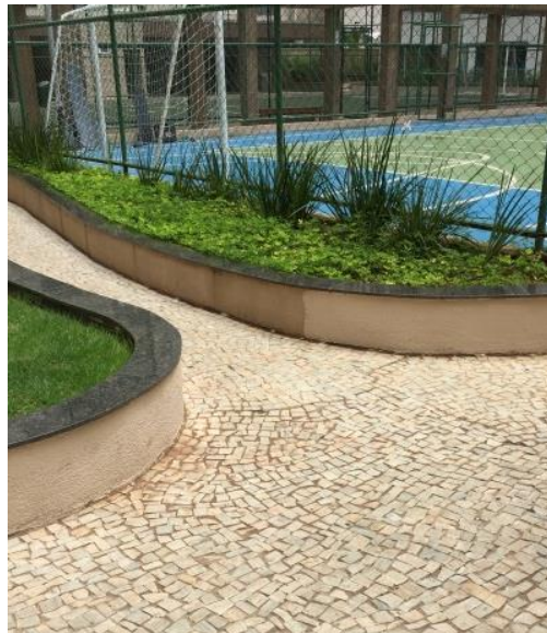
Figura 79. Ausência de rejunte no granito e trincas nas muretas de jardim.
