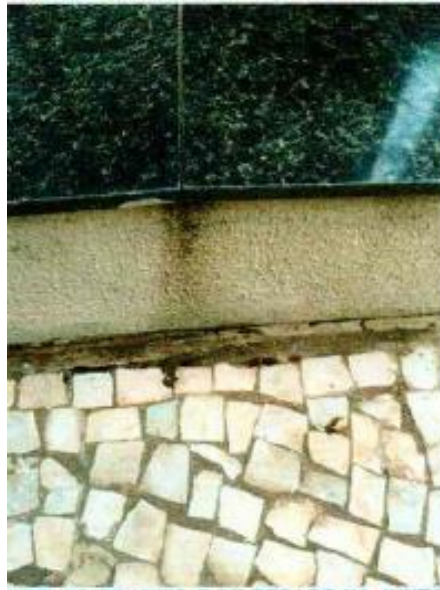
Figura 104. Ausência de rejunte no granito e de reparo na junta da base mureta de jardim.
