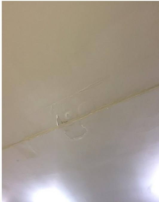
Figura 187.Ponto de infiltração no gesso.
