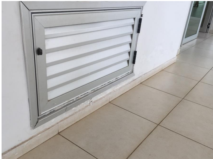
Figura 59. Pontos de infiltração em parede.
