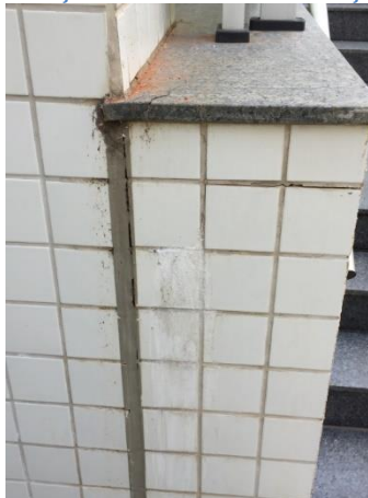
Figura 201. Trincas, junta de dilatação ressecadas e infiltração por de trás da peça cerâmica.
