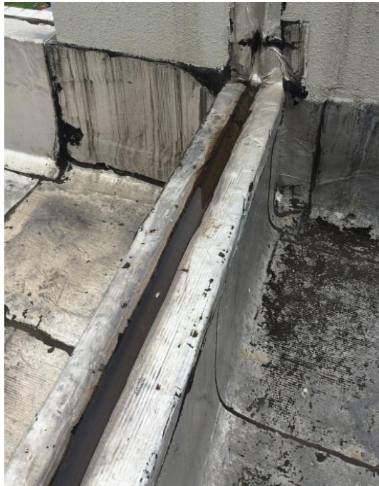
Figura 268. Acumulo de água.
