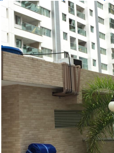
Figura 135. Sistema de aquecimento da piscina.
