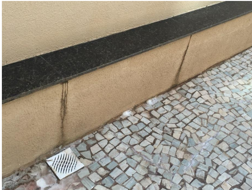
Figura 103. Ausência de rejunte no granito e de reparo na junta da base mureta de jardim.
