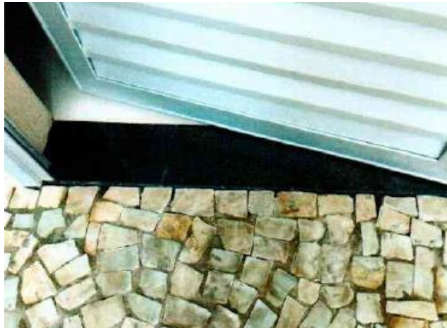
Figura 162. Trinca na mureta e no piso.
