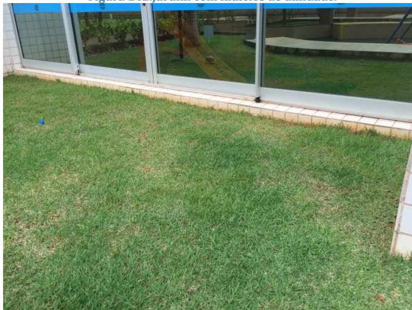
Figura 143. Jardim com indícios de umidade.
