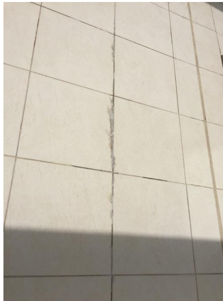
Figura 50. Ausência de rejunte.
