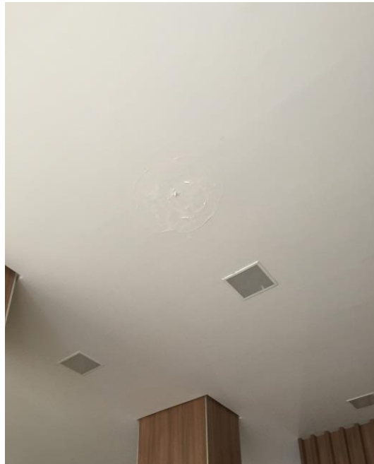
Figura 149. Sinal de infiltração no teto.
