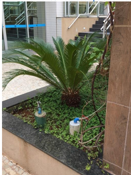
Figura 118. Torneiras instaladas pelo Condomínio.
