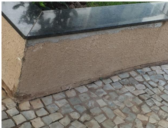
Figura 100. Ausência de rejunte no granito e de reparo na junta da base mureta de jardim.
