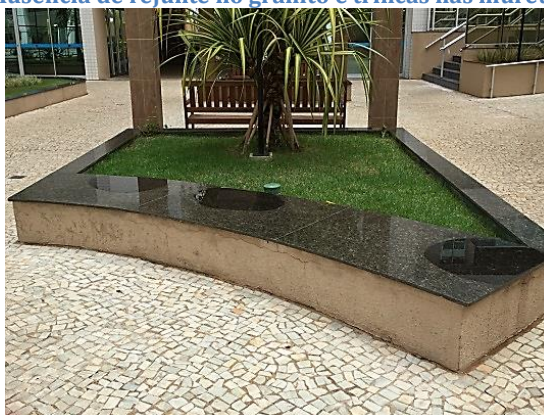
Figura 86. Ausência de rejunte no granito e trincas nas muretas de jardim.
