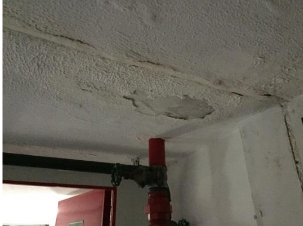
Figura 234. Infiltração dentro de escadas de emergência.
