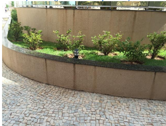
Figura 108. Ausência de rejunte no granito e de reparo na junta da base mureta de jardim.
