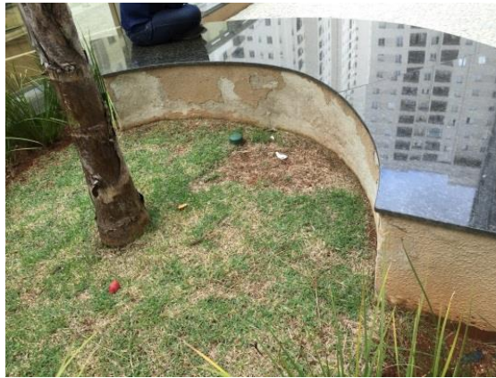
Figura 111. Ausência de rejunte no granito e de reparo na junta da base mureta de jardim.
