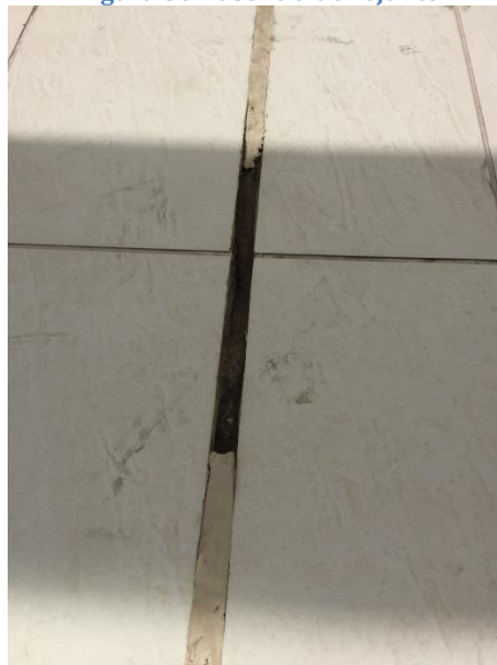
Figura 51. Ausência de reparo em junta de dilatação.
