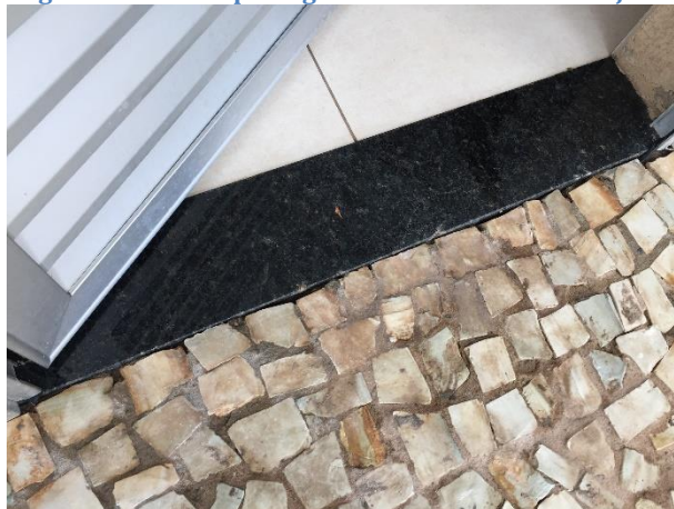
Figura 133. Pedra portuguesa danificada e sem rejunte.
