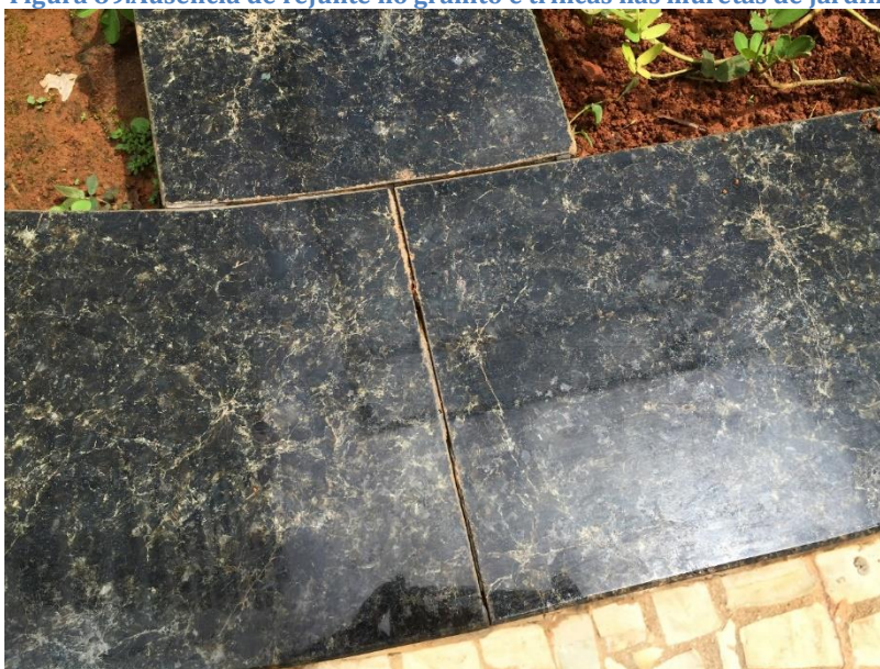
Figura 90. Ausência de rejunte no granito e trincas nas muretas de jardim.
