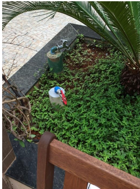
Figura 117. Torneiras instaladas pelo Condomínio.
