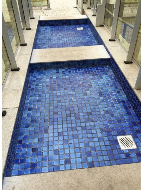
Figura 27..Lava-pés da piscina sem água e com falta de rejunte entre as pastilhas.
