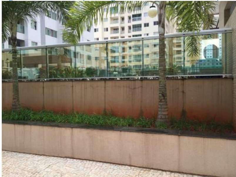
Figura 88. Ausência de rejunte no granito e trincas nas muretas de jardim.
