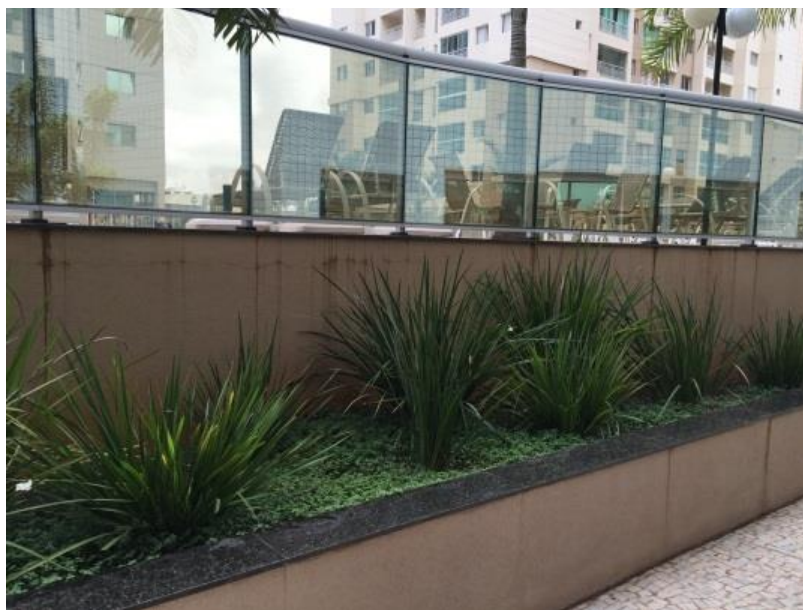
Figura 24..Trinca e sinais de infiltração no deck da piscina.
