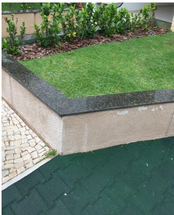
Figura 144. Muretas com pintura descascando.
