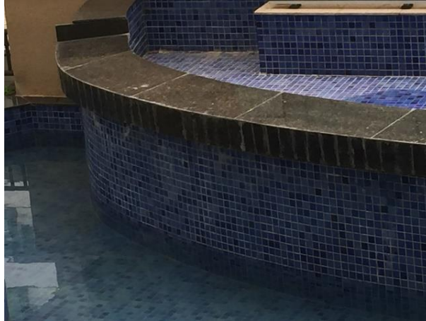
Figura 127. Ausência de rejunte no granito e trincas no muro no nível da piscina.
