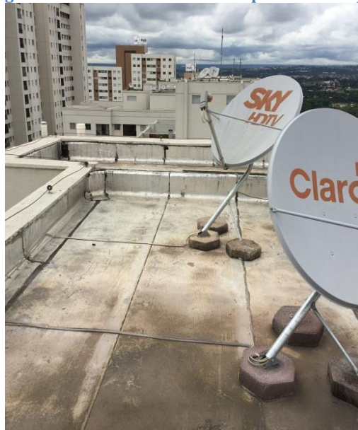
Figura 271. Danos na manta de impermeabilização.
