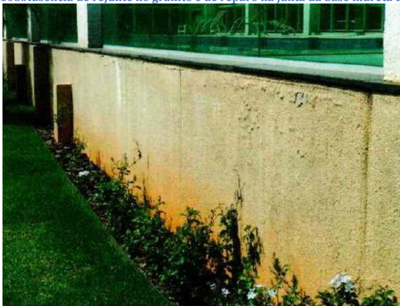
Figura 106. Ausência de rejunte no granito e de reparo na junta da base mureta de jardim.
