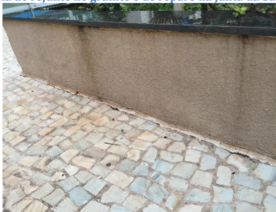
Figura 112. Ausência de rejunte no granito e de reparo na junta da base mureta de jardim.
