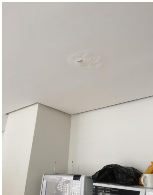
Figura 188.Indício de infiltração.
