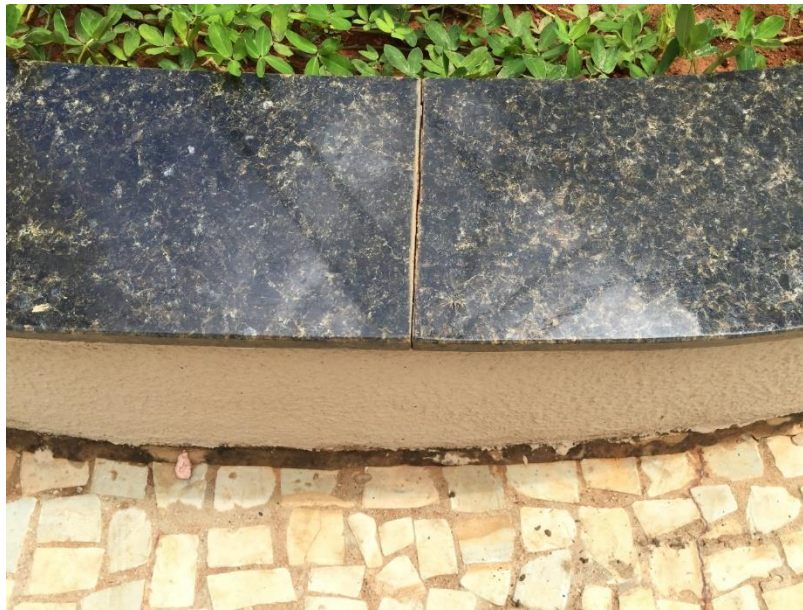
Figura 87. Ausência de rejunte no granito e trincas nas muretas de jardim.
