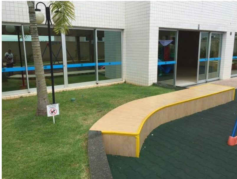
Figura 142. Jardim com indícios de umidade.
