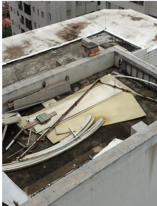
Figura 261. Acumulo de entulho.
