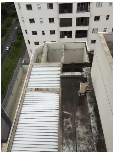
Figura 5. Fechamento da cobertura realizado pelo proprietário.
