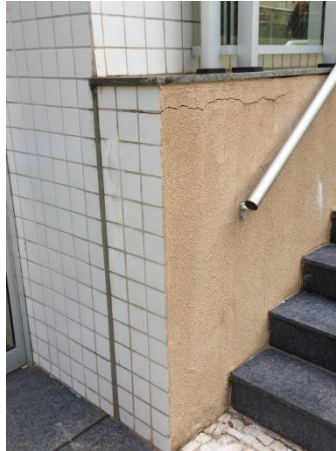
Figura 200. Trincas, junta de dilatação ressecadas e infiltração por de trás da peça cerâmica.
