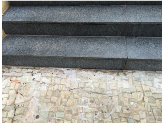
Figura 202. Ausência de rejunte, junta de vedação solta, e infiltração.
