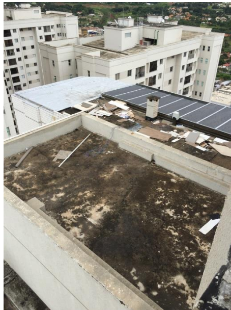
Figura 1. Entulho na cobertura.
