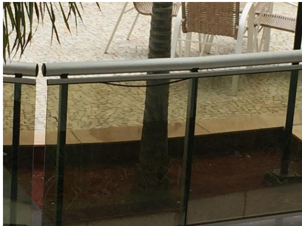
Figura 25. Baguete de borracha para fixação do vidro solto e vidro quebrado na piscina.
