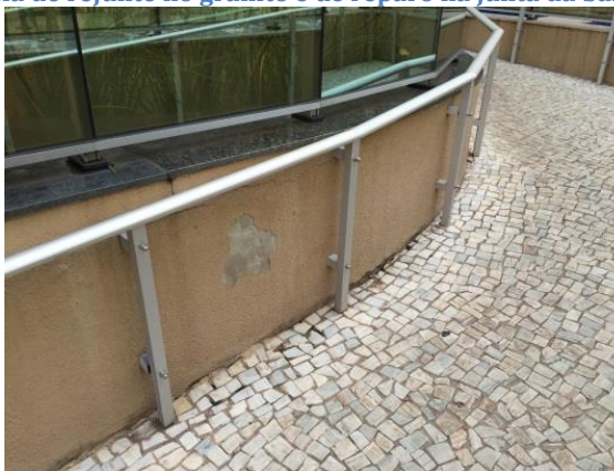
Figura 110. Ausência de rejunte no granito e de reparo na junta da base mureta de jardim.
