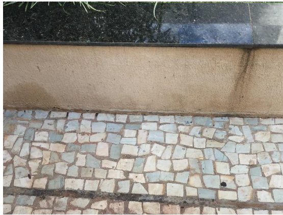
Figura 109. Ausência de rejunte no granito e de reparo na junta da base mureta de jardim.
