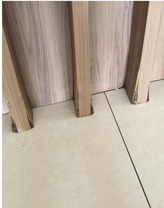
Figura 155. Painel de madeira danificado por água.
