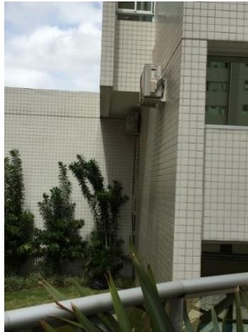
Figura 58. Aparelho de ar condicionado instalado posteriormente.
