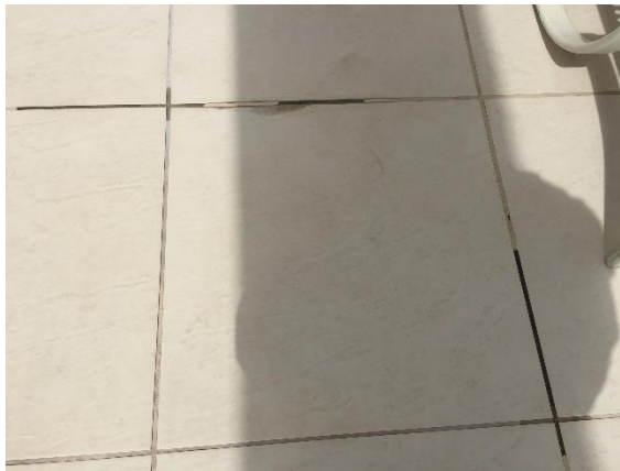
Figura 46. Cerâmica sem rejunte.
