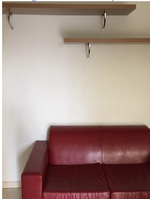
Figura 231. Fissura na parede.
