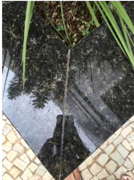
Figura 78. Falha no rejunte das peças de granito nas jardineiras.
