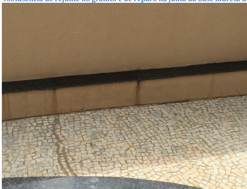
Figura 97. Ausência de rejunte no granito e de reparo na junta da base mureta de jardim.
