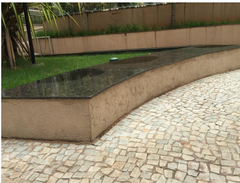
Figura 89. Ausência de rejunte no granito e trincas nas muretas de jardim.
