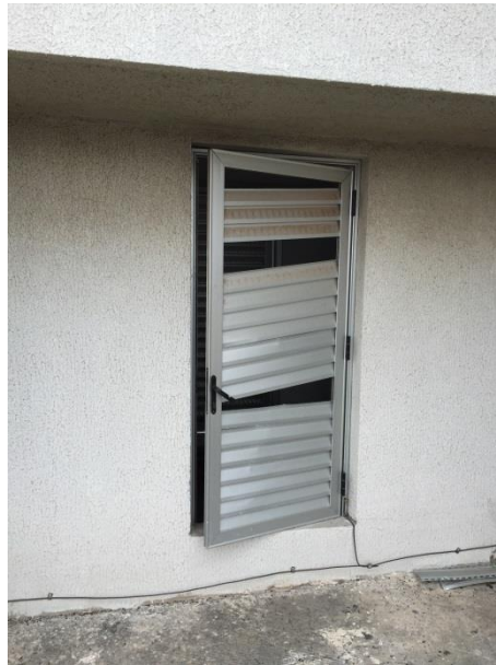
Figura 3..Porta de acesso à cobertura danificada.
