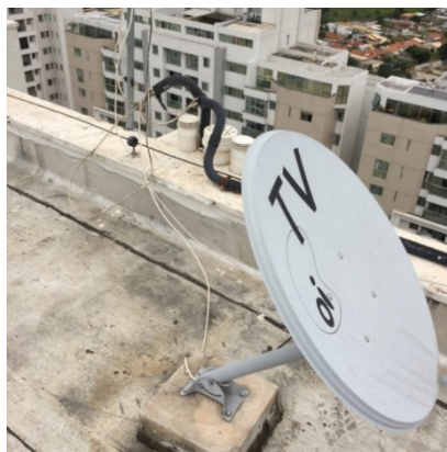
FIGURA 28. DESORGANIZAÇÃO DE CABEAMENTOS E DANOS NA TUBULAÇÃO.
