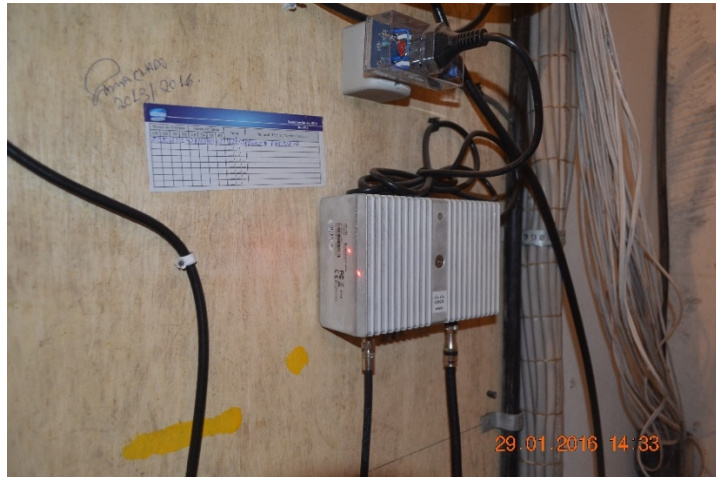
FIGURA 77. QUADRO PRINCIPAL DE TELEFONIA.
