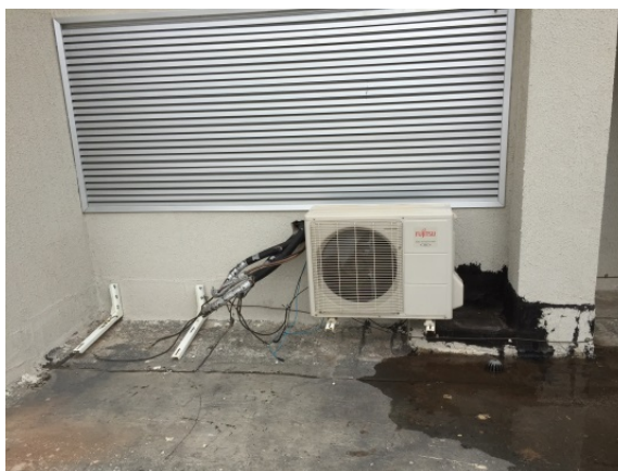
FIGURA 22. APARELHO DE AR CONDICIONADO INSTALADO NA COBERTURA.
