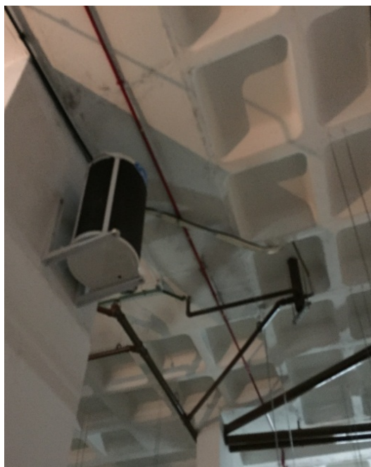
FIGURA 63. APARELHO DE AR CONDICIONADO INSTALADO NO SUBSOLO.
