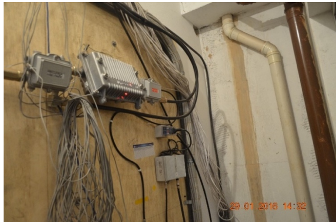
FIGURA 75. QUADRO PRINCIPAL DE TELEFONIA.
