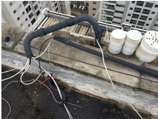
FIGURA 5. DESORGANIZAÇÃO E DANOS NA TUBULAÇÃO ENTREGUE ORIGINALMENTE.
