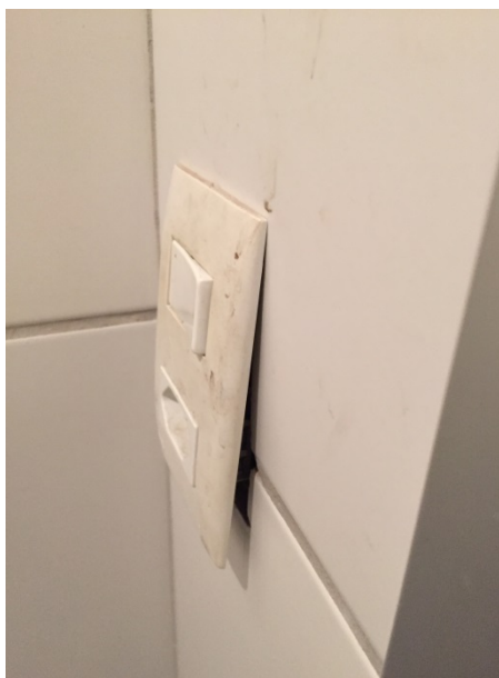
FIGURA 13.CAIXA DE INTERRUPTOR DESLOCADA.
