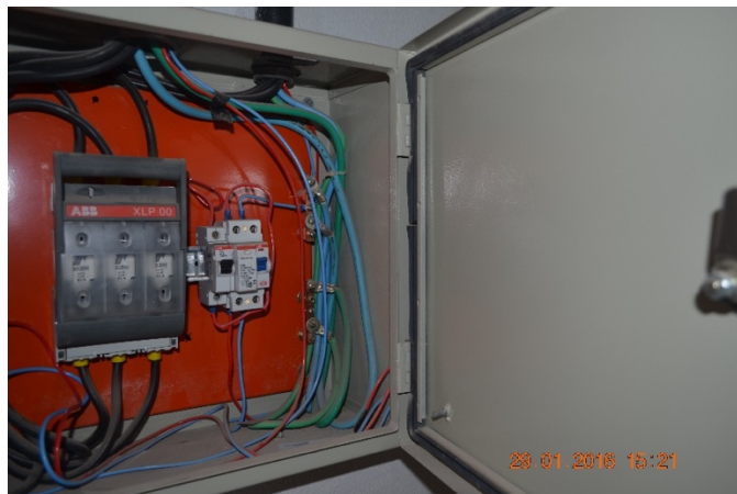
FIGURA 109. QUADROS SEM IDENTIFICAÇÃO DOS CIRCUITOS.
