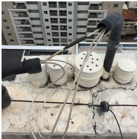
FIGURA 32..DESORGANIZAÇÃO DE CABEAMENTOS E DANOS NA TUBULAÇÃO.
