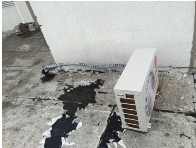
FIGURA 4. APARELHO DE AR CONDICIONADO INSTALADO NA COBERTURA.
