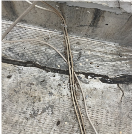
FIGURA 31.DESORGANIZAÇÃO DE CABEAMENTOS E DANOS NA TUBULAÇÃO.
