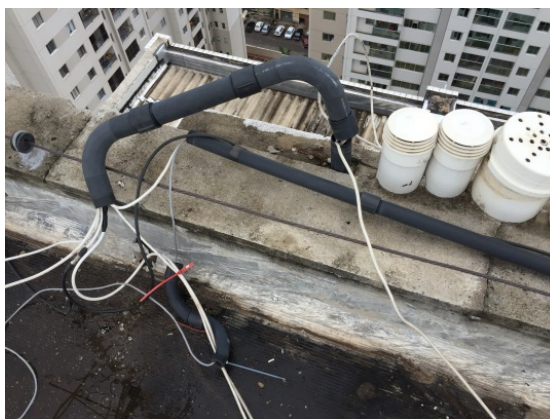
FIGURA 6. DESORGANIZAÇÃO E DANOS NA TUBULAÇÃO ENTREGUE ORIGINALMENTE.
