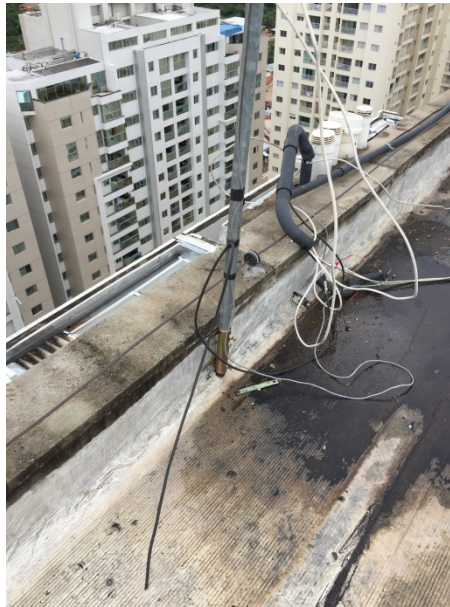
FIGURA 7. INSTALAÇÃO DE ANTENA DANIFICANDO MANTA DE IMPERMEABILIZAÇÃO.
