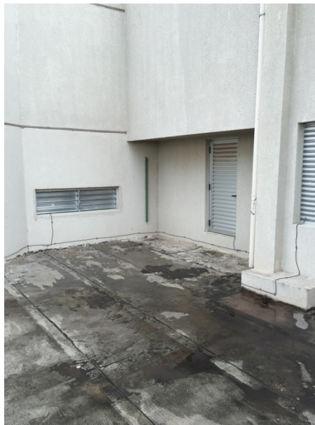
FIGURA 1. ATERRAMENTO REALIZADO PELO CONDOMÍNIO.
