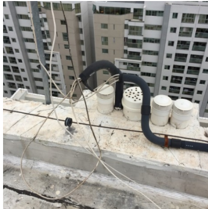
FIGURA 27. DESORGANIZAÇÃO DE CABEAMENTOS E DANOS NA TUBULAÇÃO.
