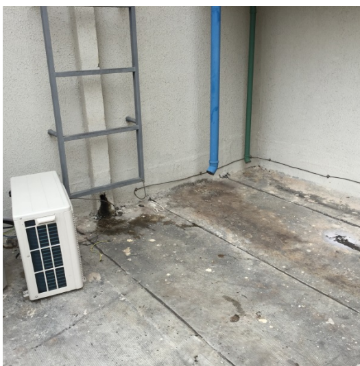
FIGURA 26. INSTALAÇÃO DE AR CONDICIONADO COM BURACOS FEITOS NA PAREDE.
