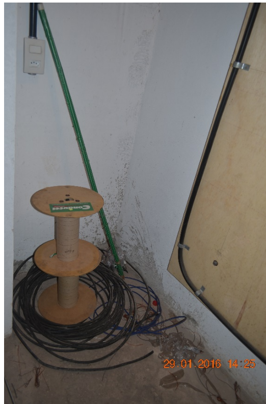
FIGURA 74. CIRCUITOS NÃO IDENTIFICADOS E DESORGANIZADOS.
