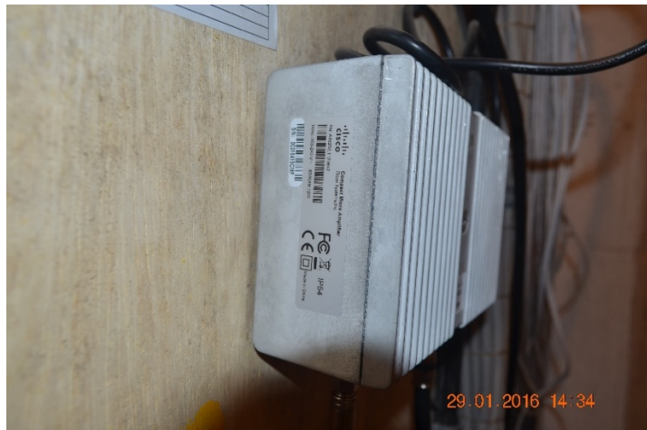
FIGURA 79. QUADRO PRINCIPAL DE TELEFONIA.
