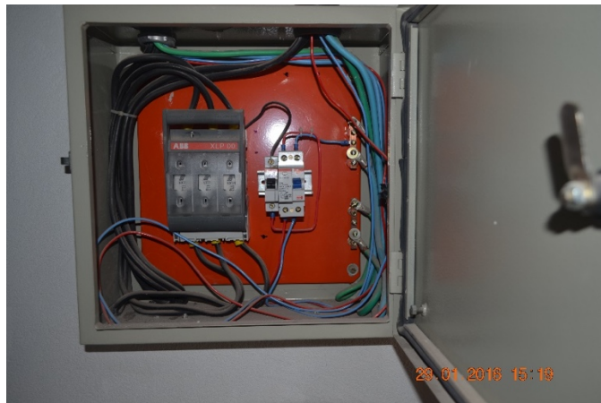
FIGURA 108. QUADROS SEM IDENTIFICAÇÃO DOS CIRCUITOS.
