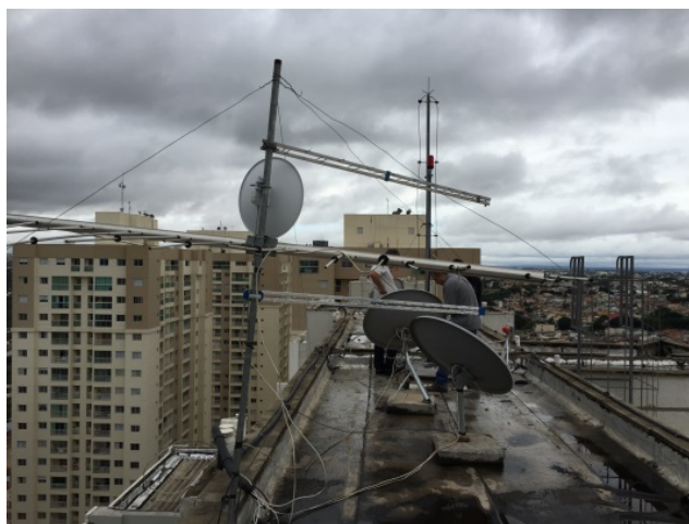
FIGURA 8. INSTALAÇÃO DE ANTENA DANIFICANDO MANTA DE IMPERMEABILIZAÇÃO.
