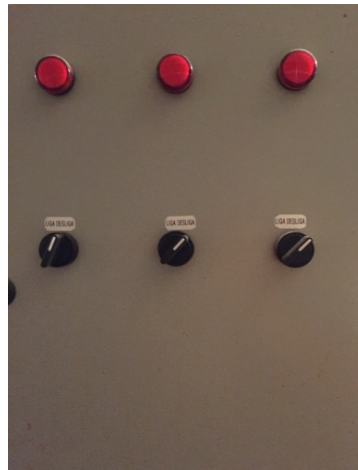
FIGURA 12.BOMBAS DE SPRINKLER DESLIGADAS.
