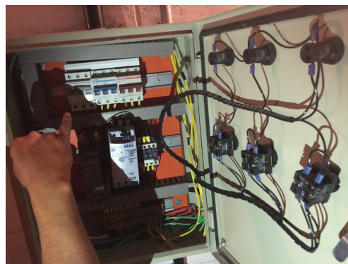
FIGURA 13.BOMBAS DE SPRINKLER DESLIGADAS.
