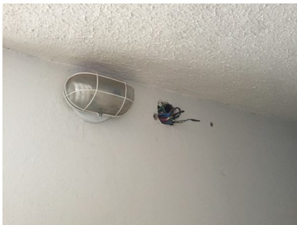
FIGURA 1.LUMINÁRIA DE EMERGÊNCIA EM FALTA.
