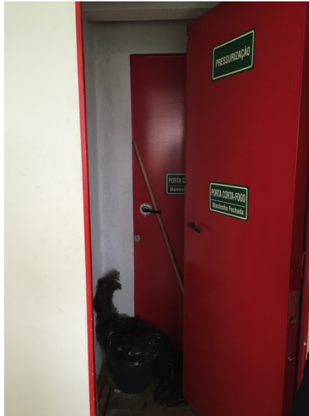
FIGURA 3. ANTECÂMARA DO CÔMODO DE PRESSURIZAÇÃO DE ESCADAS UTILIZADO COMO DEPÓSITO DE BALDES E VASSOURAS.
