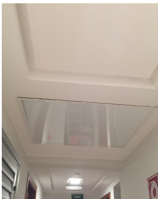
FIGURA 17. CONTRAMARCO DA VISITA À VÁLVULA REDUTORA DE PRESSÃO SOLTANDO.
